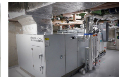
3階空調機械室
